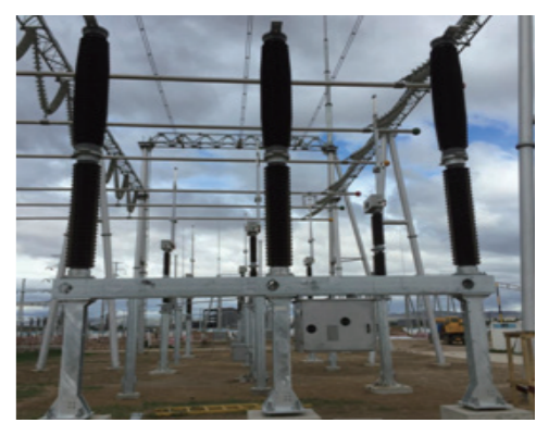
高压开关操作机构
